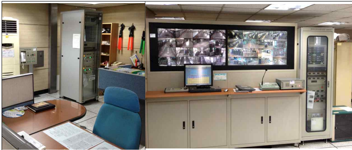
<그림 11> 구의역 역무실의 승강장안전문 종합제어반, 경보제어반, 모니터
